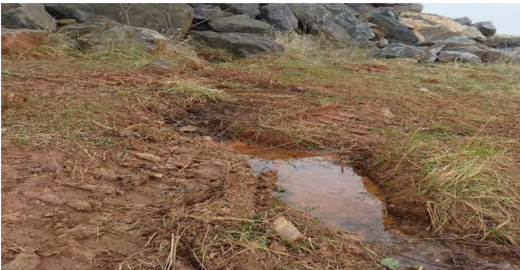
Abb. 49: Schichtwasseraustritt südwestlich der Halde, Kraus (2024)
