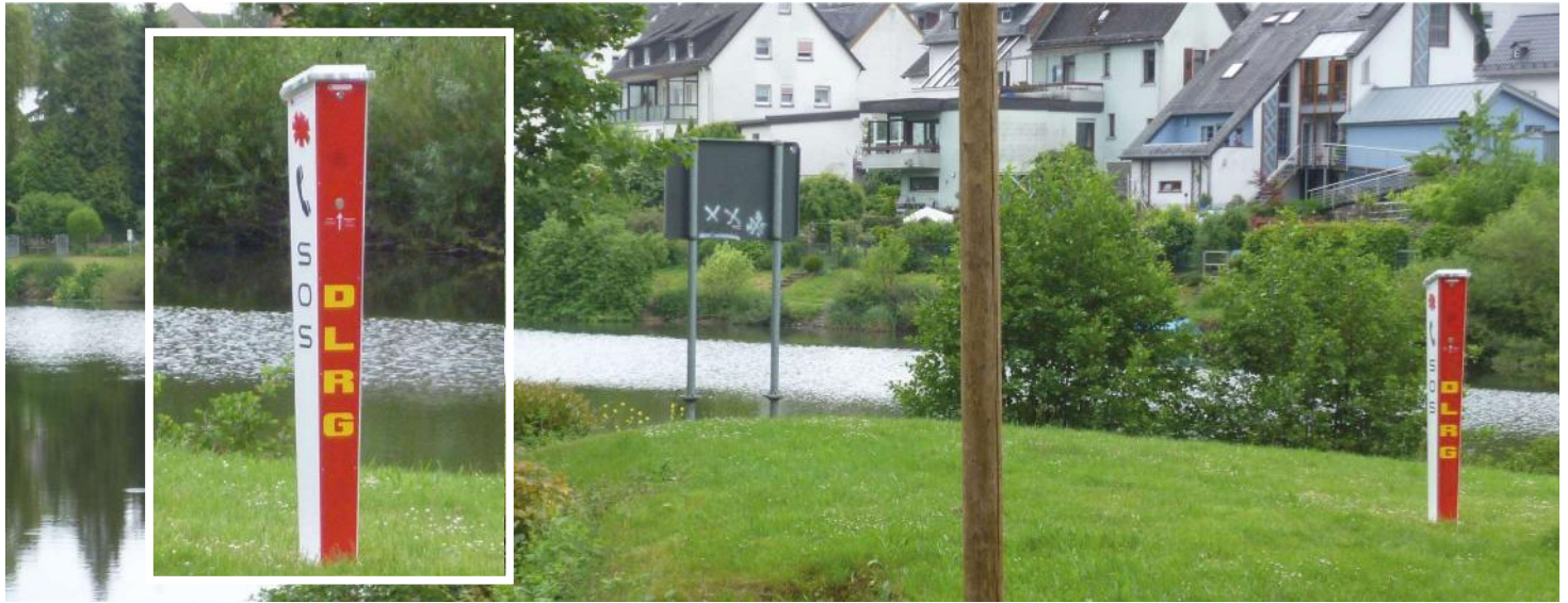
Sie hilft jetzt auch im (hoffentlich nicht eintretenden) Notfall in Runkel: die neu installierte Notrufsäule auf der Badeinsel.
